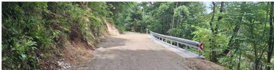
Saniran plaz na gozdni cesti Zimšek-Lipa 1
