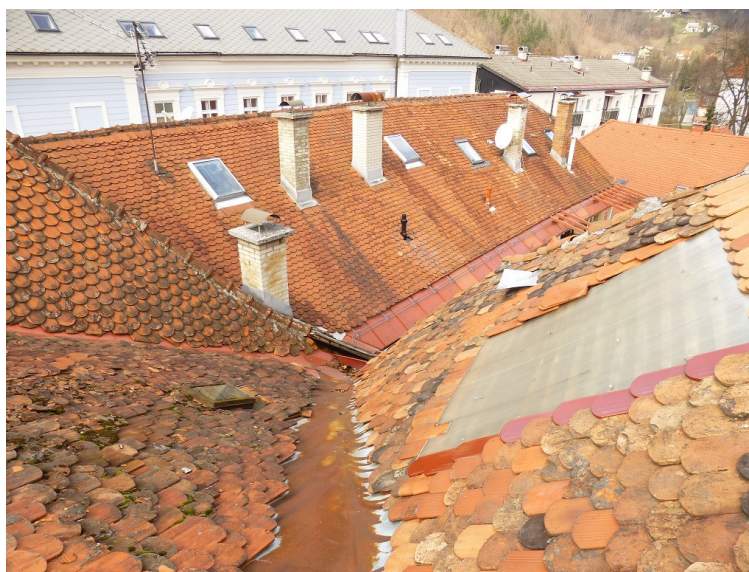
Slika: Streha nujno potrebna zamenjave, Valvasorjev trg 8, Laško
