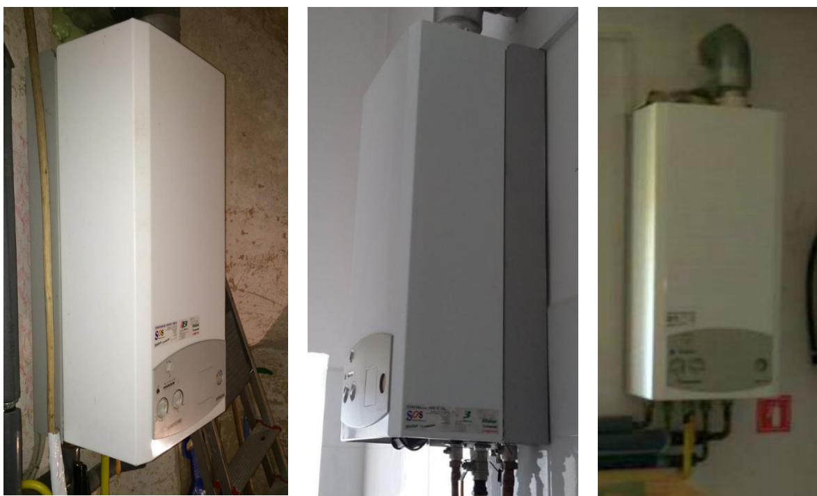
Slika 2: Kotli na UNP
